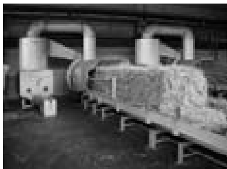
10 Centrální výtopna na spalování biomasy ve Žluticích
